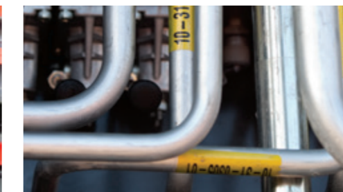
Tubagens em aço para uma melhor dissipação do calor
